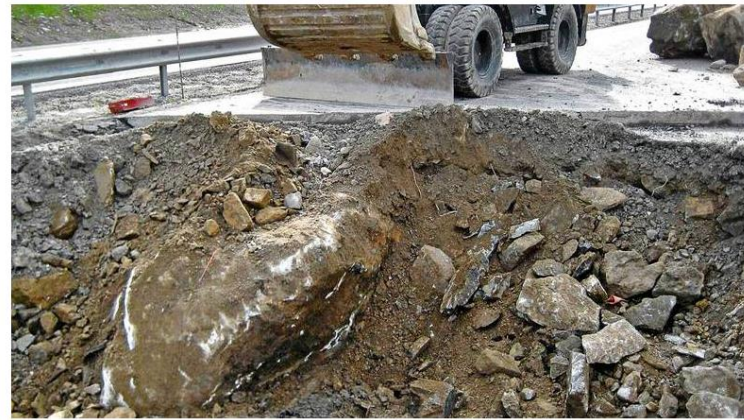
Denne fire meter store steinblokken lå rett under asfalten på den teleskadede veien.
