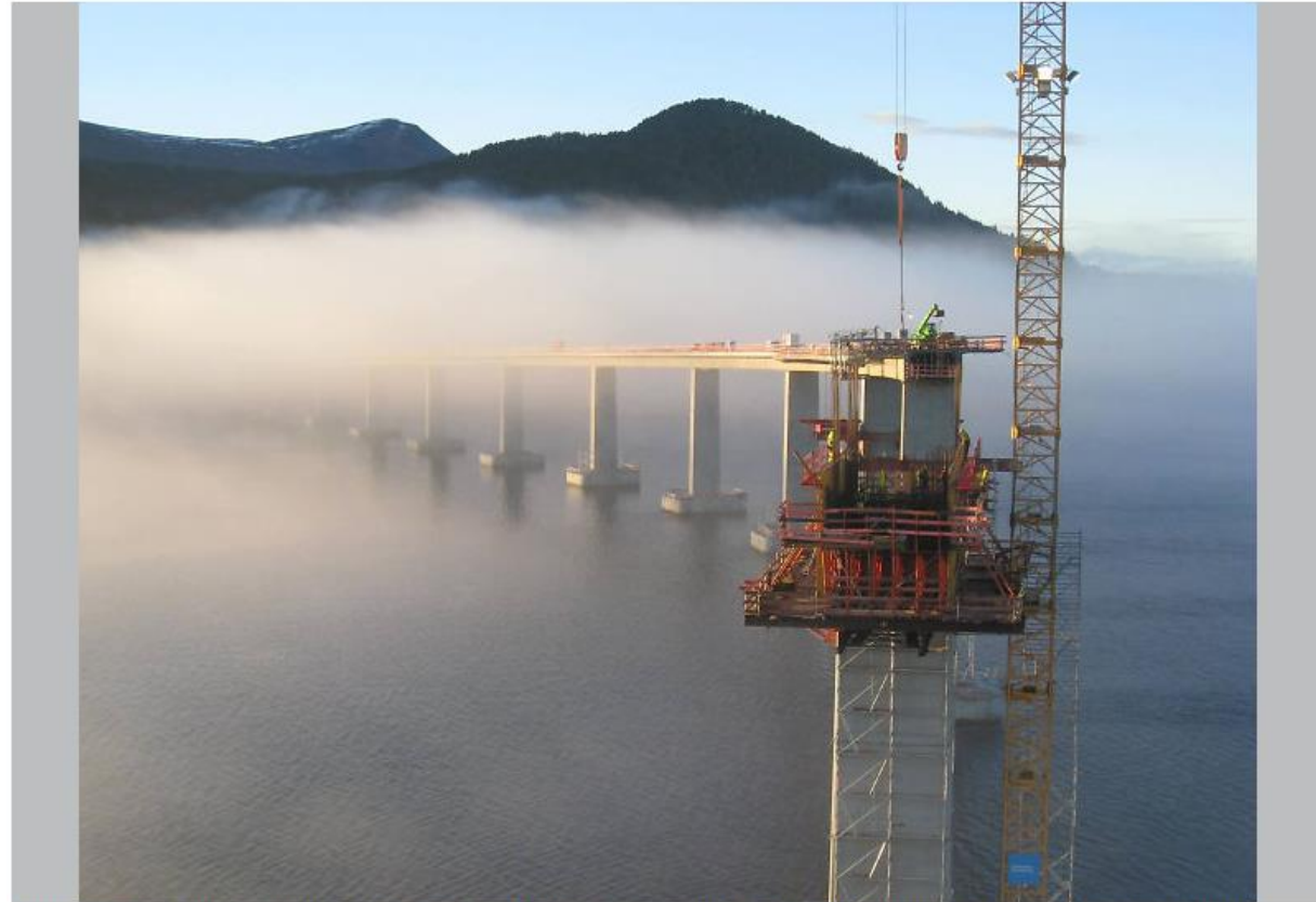
Under byggingen av Tresfjordbrua i Møre og Romsdal blir det kjørt et testprosjekt med lavvarmebetong og tidlig påføring av kloridbremsende overflatebehandling. Foto: Statens vegvesen.
